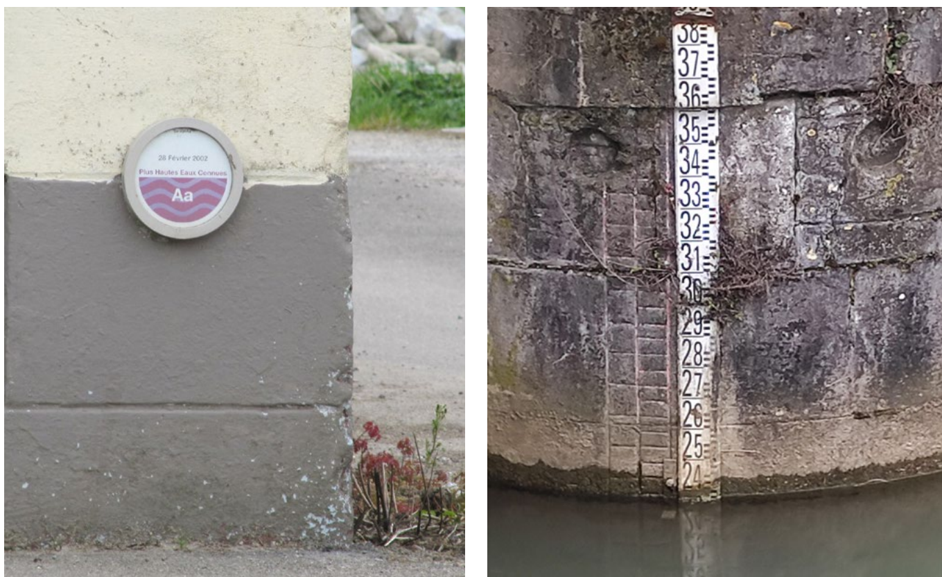
Photo 12 : Repère de crue et échelle limnimétrique
