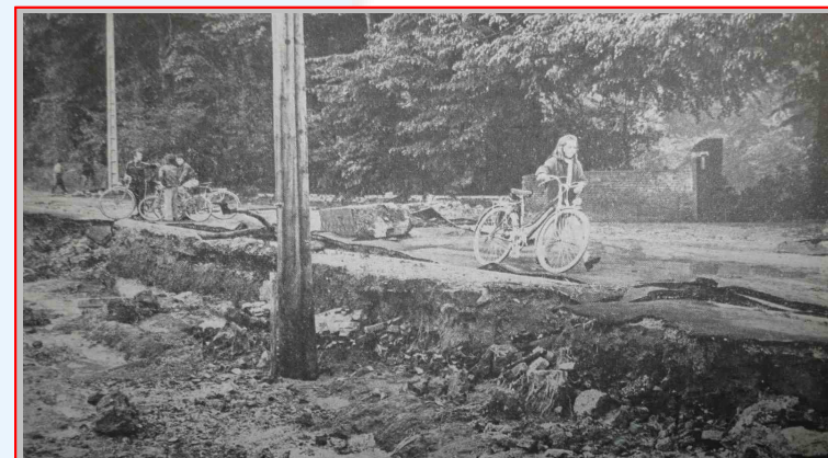
Rue des Chartreux à Longuenesse, sur le point de passage du flot d'eau le mur de la propriété de M. Guilbert a été emporté et la plaque de bitume de la chaussée soulevée.
